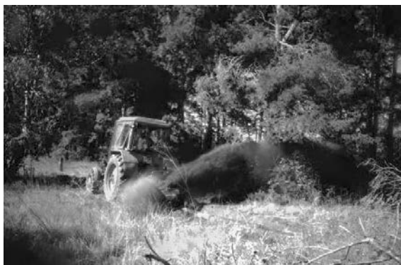
Рис. 2. Прокладка минерализованной полосы с засыпкой грунтом трактором МТЗ-82 («Беларусь») с лесопожарным фрезерным агрегатом АЛФ-10
